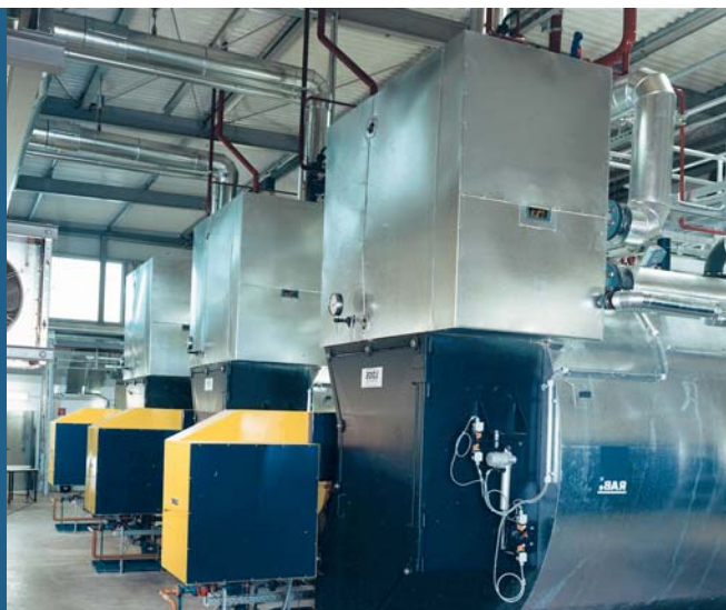
Obrázek 2: Ukázka instalace v papírně - tři parní kotle s parními přehříváky
