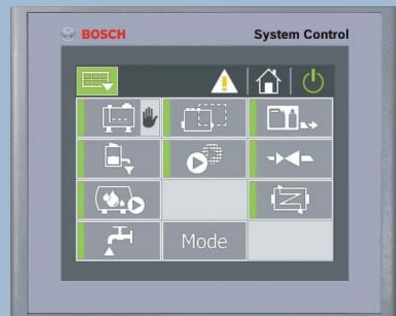
Obr. 7: Řídicí systém kotelny SCO sbírá a ukládá relevantní data vody a řeší úlohy řízení v oblasti bezpečnosti a regulace provozu.
