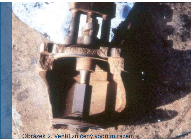
Obrázek 2: Ventil zničený vodním rázem
