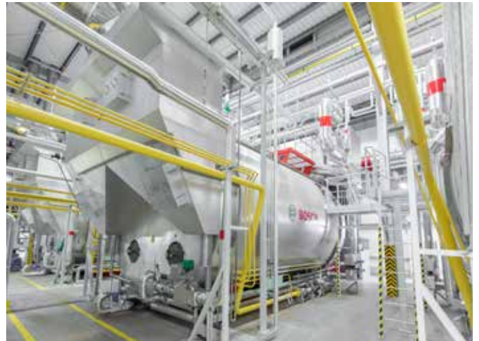
Aufgesetzter Economiser für uneingeschränkter Einzelbetrieb der Brenner getrennt. Somit ist der Einzelbetrieb der Brenner zulässig.
