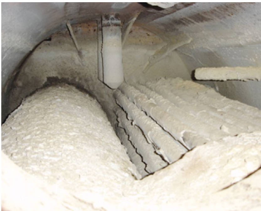
Abbildung 1: Durch mangelnde Wasseraufbereitung hat sich ein Härtebelag gebildet, der im Extremfall zur Kesselexplosion führen kann.
