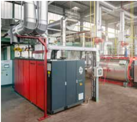
Das Bosch-BHKW liefert die Wärmegrundlast und gleichzeitig kostengünstigen Strom zum Eigenverbrauch.
