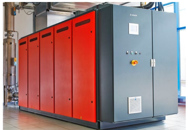
Bosch-BHKW: 240 kW elektrische Leistung, 374 kW thermische Leistung
