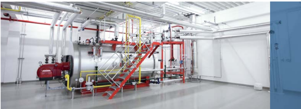
Der neue Dampfkessel ULS im ungarischen Haribo Werk.
