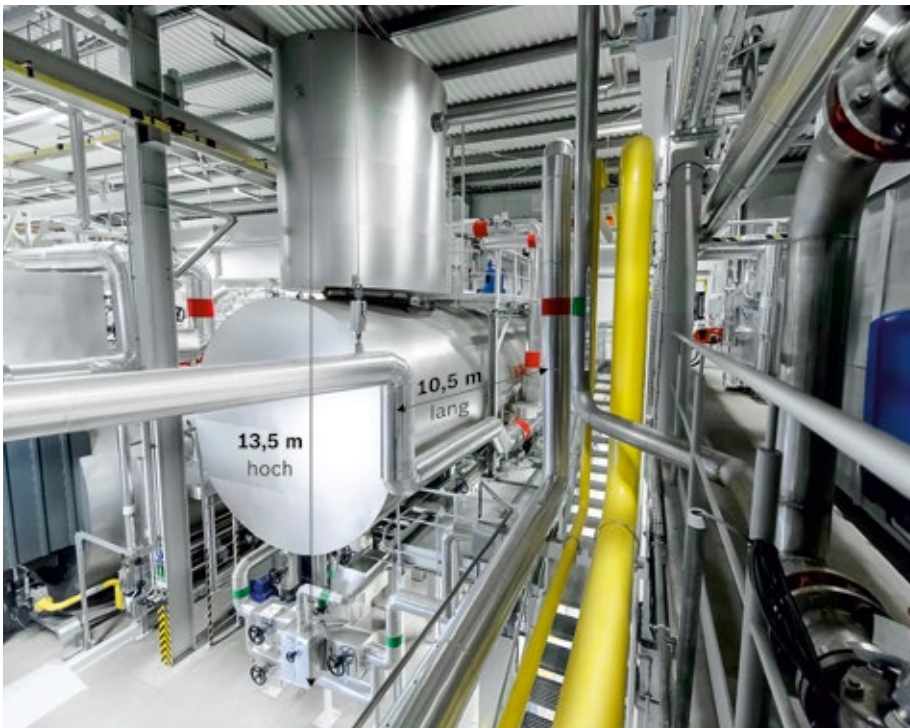
Die riesige Speisewasseranlage von Bosch, mit einer Entgasungsleistung von 177 500 kg/h, kann bis zu 100 000 l bevorraten
