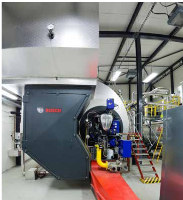
Der UL-SX Dampfkessel sorgt für einen stabilen Kraftwerksbetrieb.
