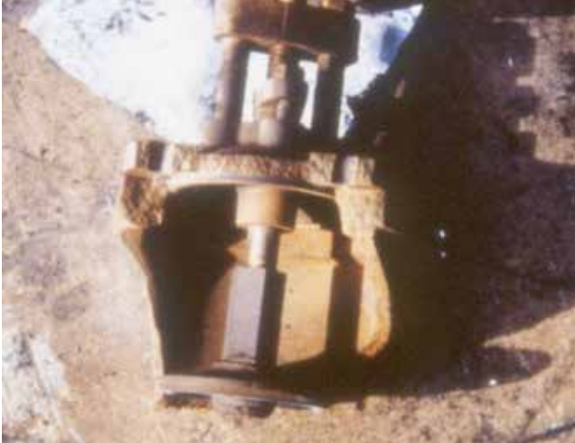
Abbildung 2: Durch Wasserschlag zerstörtes Ventil
