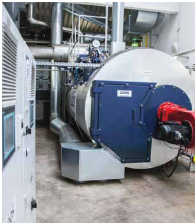
Effizienz im höchsten Maßstab: Die innovative Kesselanlage mit zusätzlichem viertem Rauchrohrzug und Eigenfeuerung.
