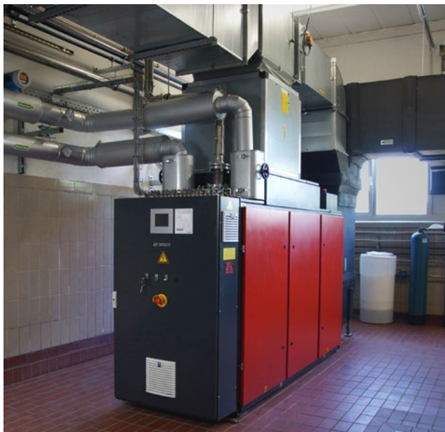
Das Druckluft-Wärme-Kraftwerk deckt bei Bahlsen mit rund 6000 bis 6500 Betriebsstunden jährlich den Grundlastbedarf an Druckluft ab.
