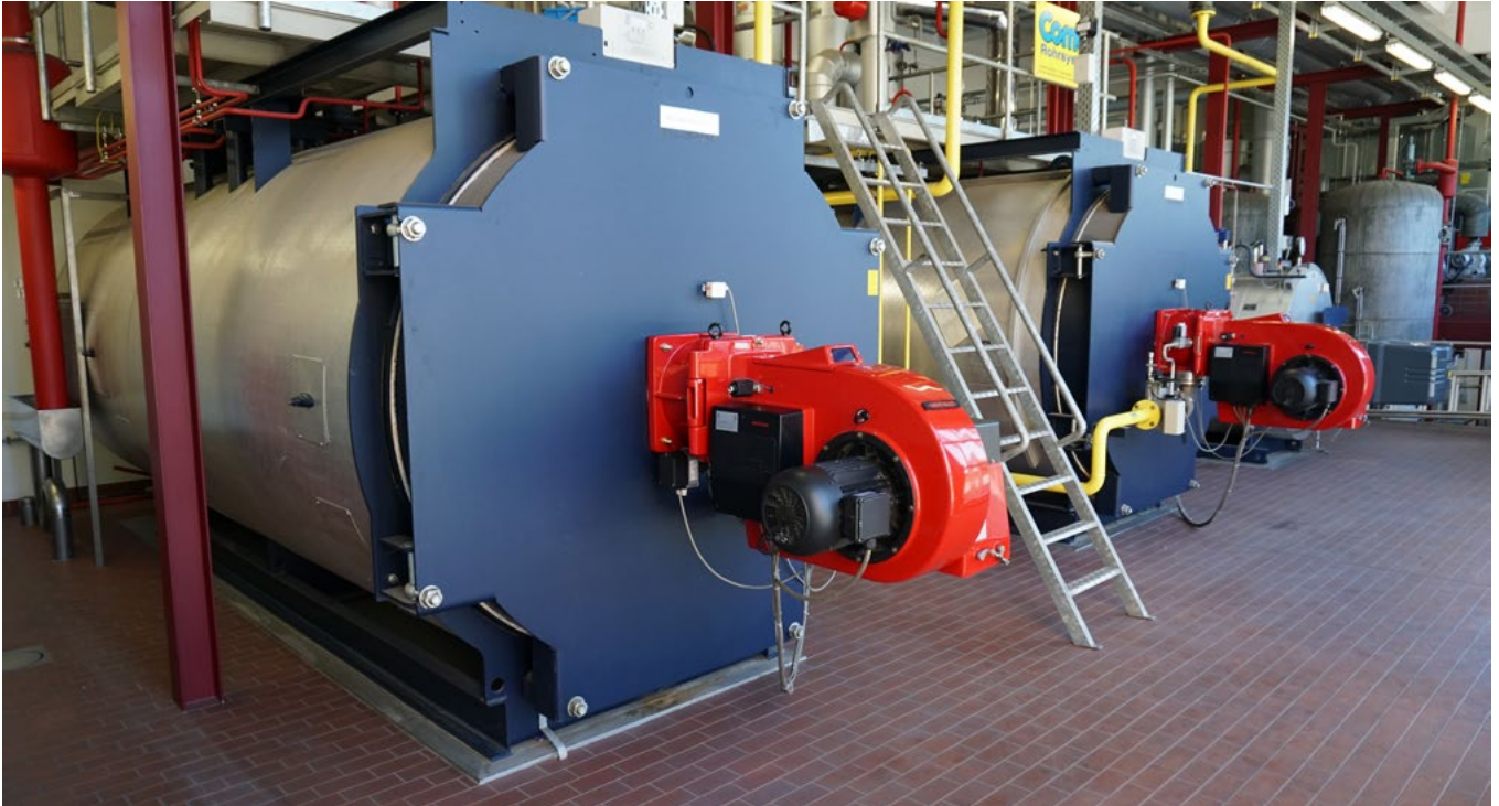
Zwei Heizkessel Unimat UT-H erzeugen eine Wärmeleistung von 7000 kW, ein Universal Dampfkessel UL-S 1250 kg/h Dampf.
