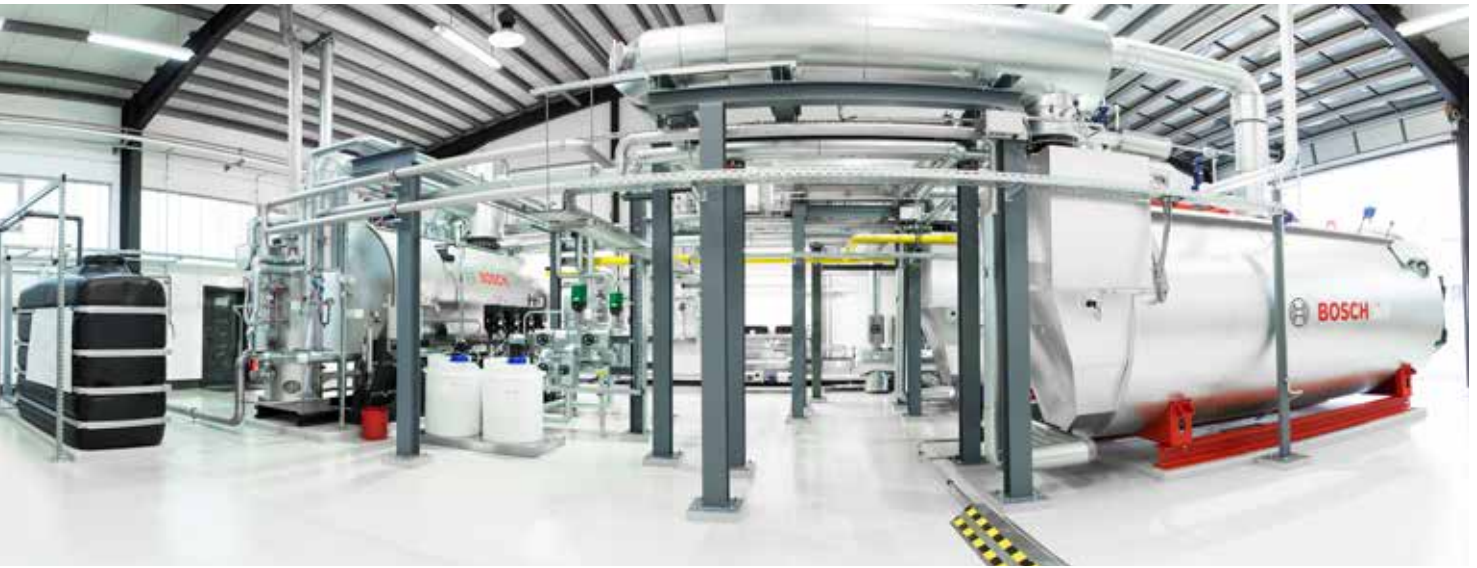
Wasserservicemodul für die Entgasung (links) und die zwei Dampfkessel UL-S.
