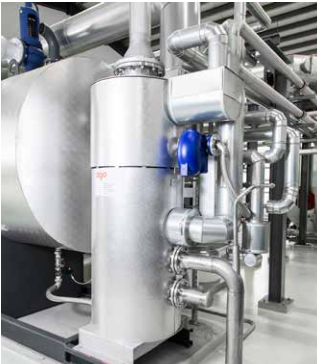
Wärmerückgewinnung aus Absalzlauge.
