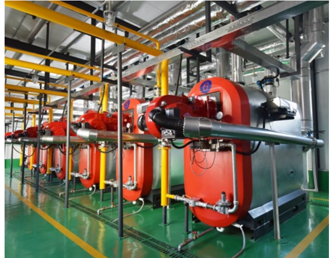
Ein Teil der Uni Condens Heizkesselsysteme aus dem ersten Auftrag im Jahr 2016 – jeder liefert 1,2 MW Wärme.
