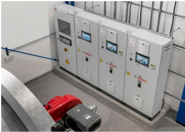
Anschlussfertige Steuerungstechnik von Bosch mit intelligenten Funktionen optimieren Betrieb und Effizienz.
