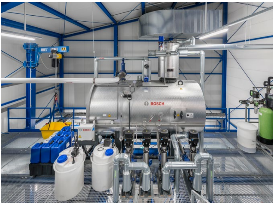
Das Wasserservicemodul WSM ist auf der zweiten Ebene des Kesselhauses installiert und versorgt die Kessel mit thermisch aufbereitetem Speisewasser.
