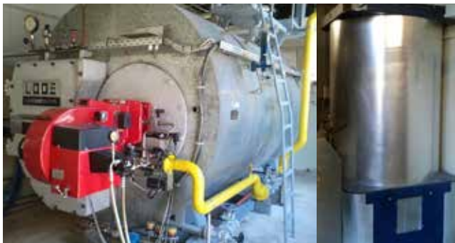
Mehr Effizienz: Die neue Feuerung mit Drehzahl- und Sauerstoffregelung sowie der nachgerüstete Economiser.
