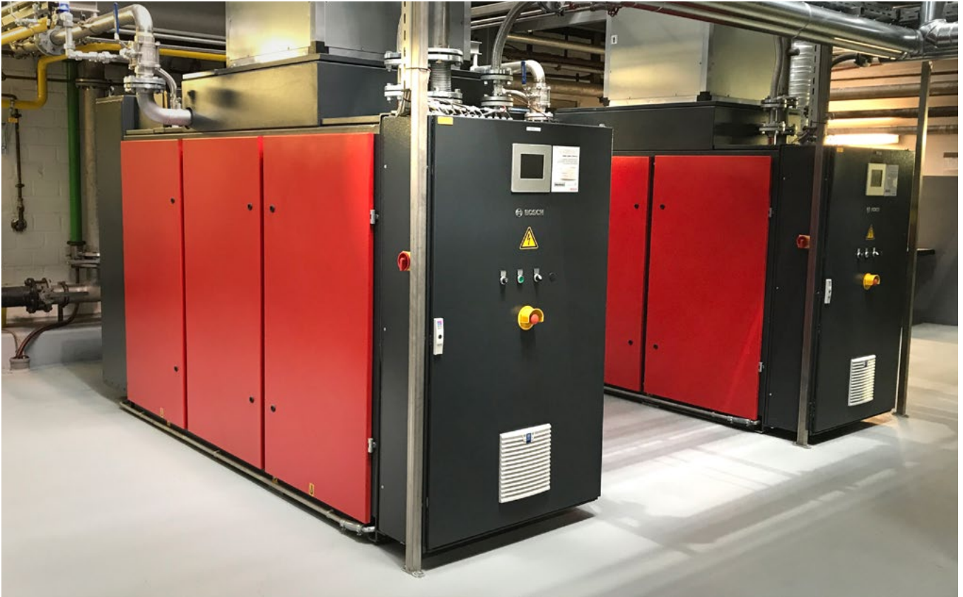
Jedes der beiden Druckluft-Wärme-Kraftwerke liefert rund 9,5 \text{ m}^3/\text{min} Druckluft und 135 \text{ kW} Wärme.
