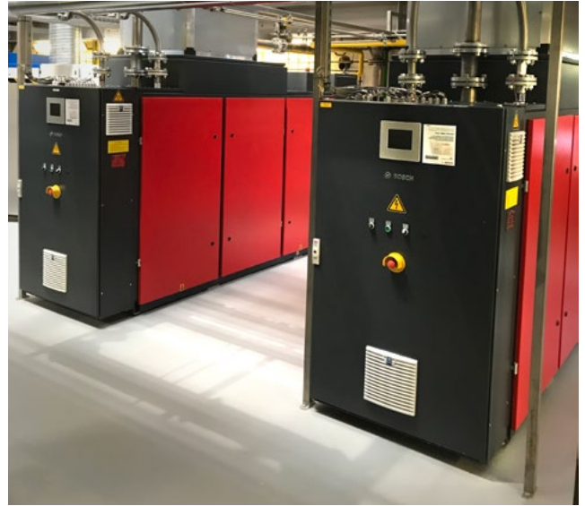
Jedes DWKW läuft rund 8400 Betriebsstunden jährlich.
