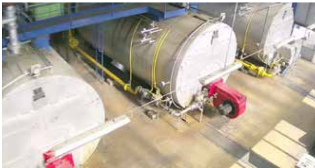
Bestandsanlage aus den 1970ern.
