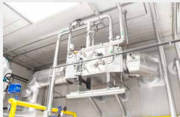
Die Kondensationswärme aus dem Brennwertwärmetauscher (Bild) und die Wärme aus dem Brüden Dampf erwärmen das Zusatzwasser vor dem Entgasungsprozess.
