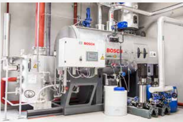
Im Wasserservicemodul findet der Entgasungsprozess des Speisewassers statt. Durch Erhitzung lösen sich korrosive Bestandteile wie Kohlendioxid und Sauerstoff.
