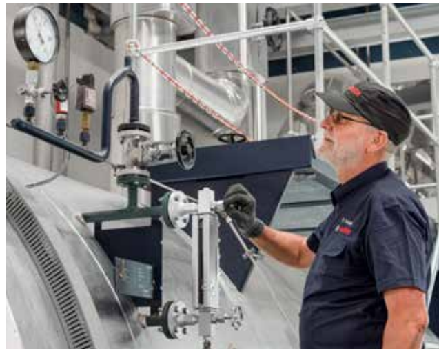
Die Inbetriebnahme der Dampfkesselanlage sowie die Begleitung der Behördenabnahme erfolgten durch den Bosch-Industrieservice.
