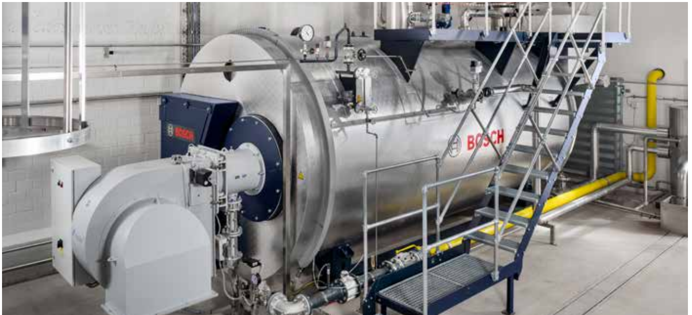
Bierbrauen ist ein energieintensiver Vorgang. Ein Großteil des Gesamtwärmeverbrauchs fällt im Sudhaus an, hauptsächlich für Maischen und Kochen. Moderne Energieversorgungsanlagen helfen, die Betriebskosten niedrig zu halten und Emissionen zu senken.
