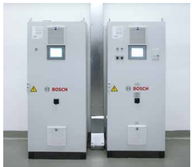
Anlagensteuerung mit Anbindung an die zentrale Leittechnik.
