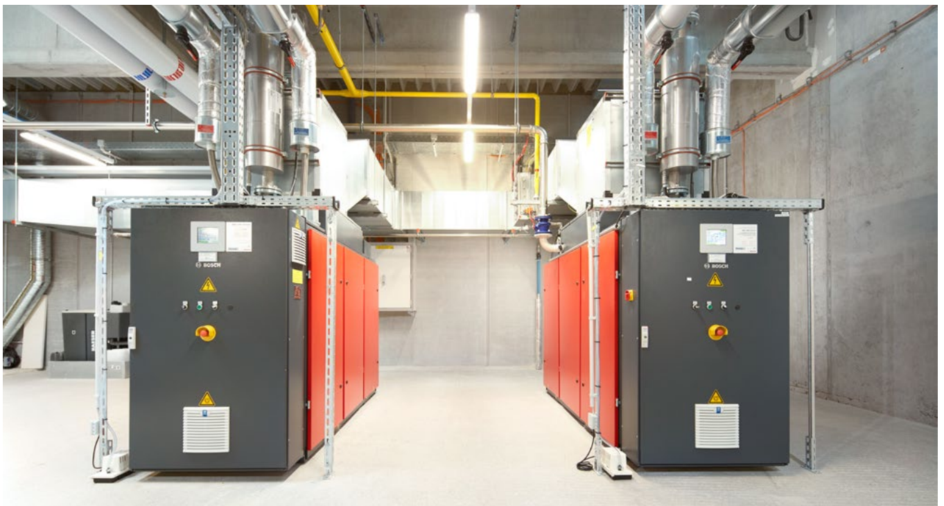
Die beiden Druckluft-Wärme-Kraftwerke von Bosch versorgen das Firmengebäude mit dem Grundlastbedarf an Druckluft von 17,5 m 3 /min und 250 kW Wärmeleistung.
