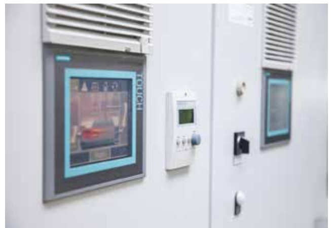
Die optimale Einstellung und Regelung der Kesselanlage erfolgt über die modernen Touch-Screen Steuerungen BCO und SCO.
