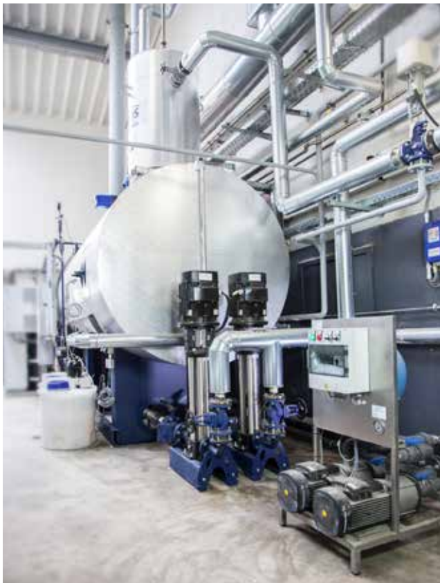
Vollautomatische Wasseraufbereitung durch das Wasserservicemodul WSM-V.
