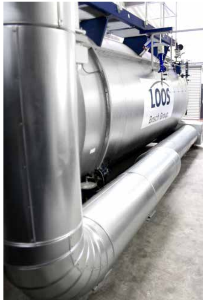
Der zusätzliche Abhitzezug verwandelt die Abgasabwärme des BHKW in Prozessdampf.
