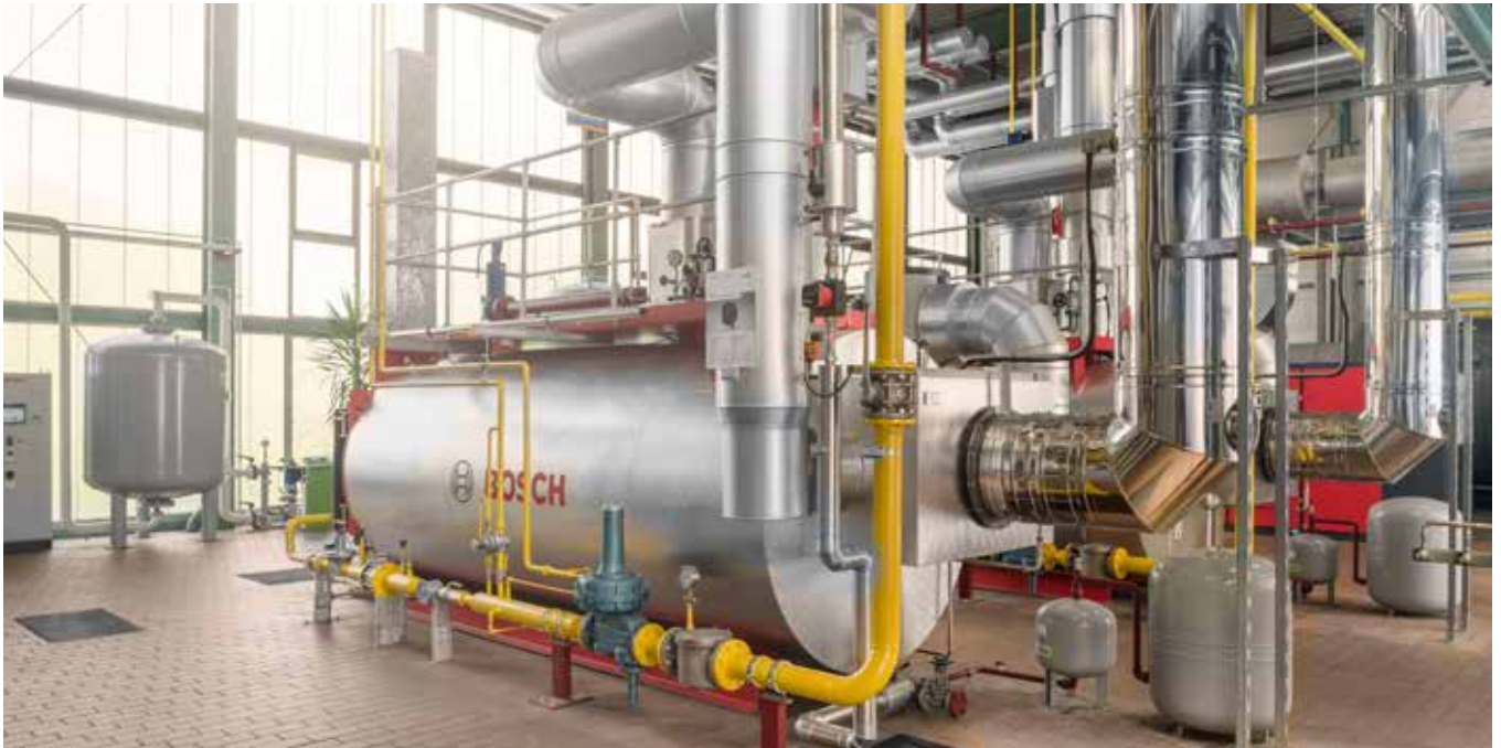
Die Heizkessel ergänzen das Wärmenetz optimal und überzeugen durch ihre hohe Effizienz.
