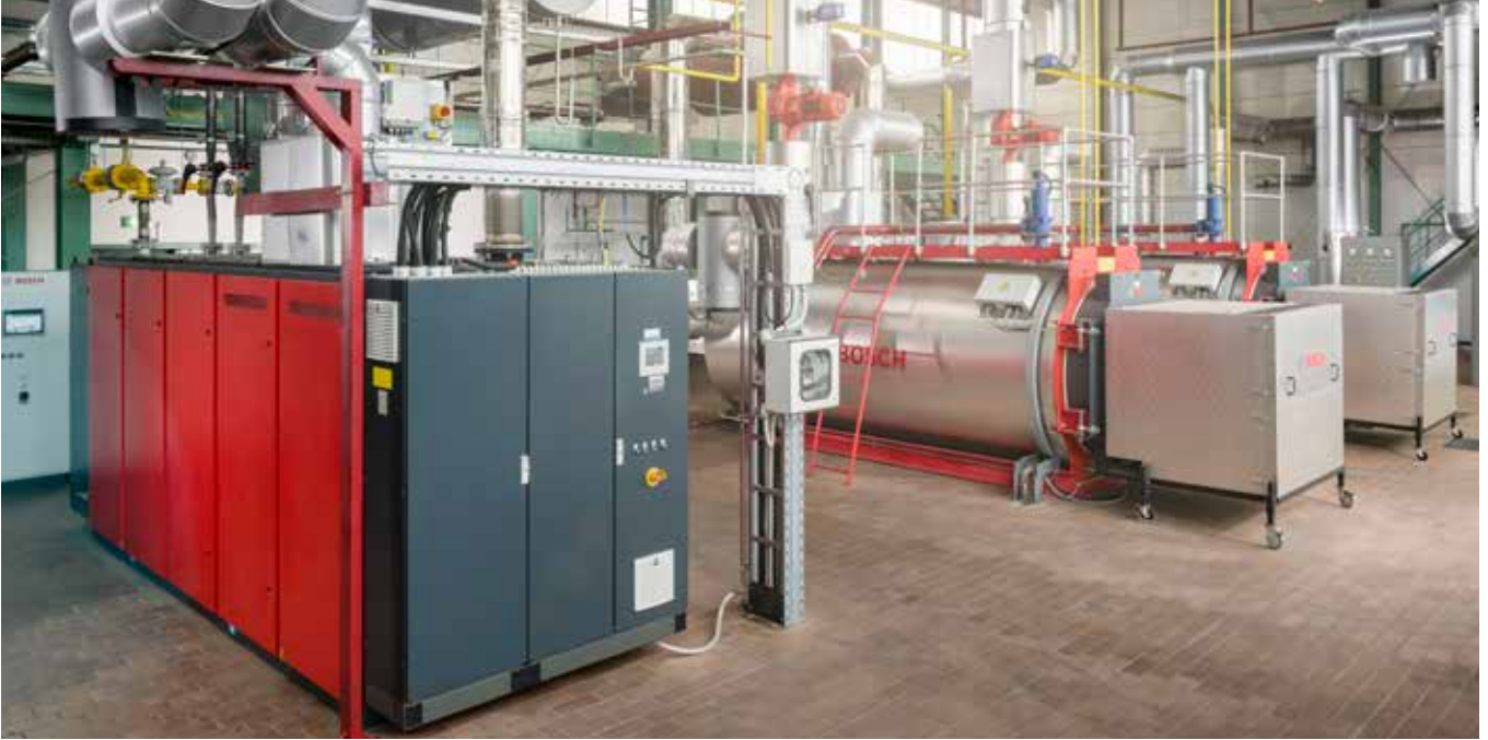
Das Bosch-BHKW liefert die Wärmegrundlast und gleichzeitig kostengünstigen Strom zum Eigenverbrauch.
