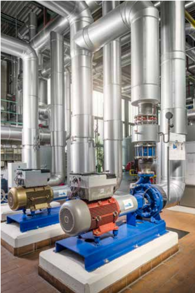
Effiziente Pumpentechnologie von KSB in eigener Heizzentrale.
