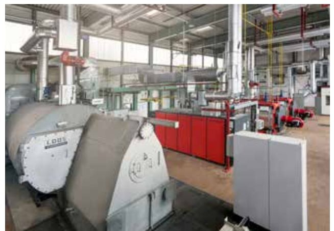
Seit Jahrzehnten in Betrieb: Der modernisierte Loos-Festbrennstoffkessel unterstützt die Wärmeerzeugung.
