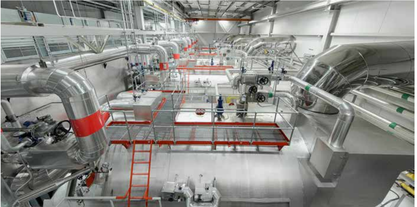
Die vier Dampfkessel ZFR-X mit einem Betriebsgewicht von jeweils 145 Tonnen.
