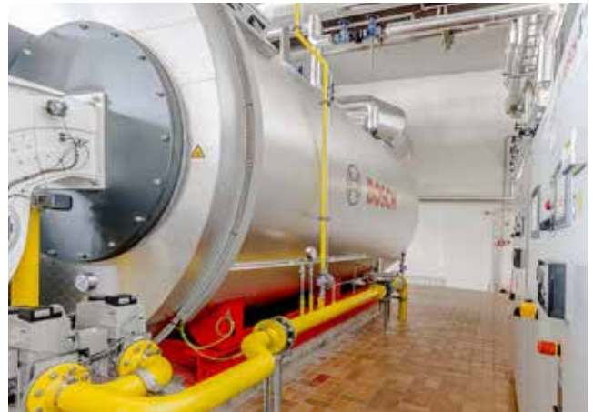
Der neue Bosch-Kessel ließ sich in das bestehende Dampfnetz schnell und effizient integrieren.
