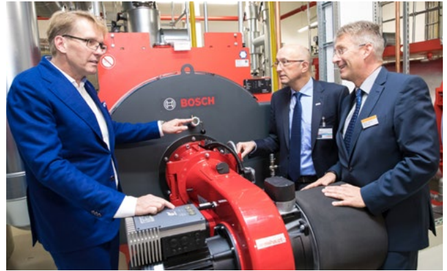
Starkes Team: Sven Koss von dem ausführenden Planungsbüro Koss Ingenieure zusammen mit Sven Evert, Bosch Industriekessel und Rainer Harms, Weishaupt.
