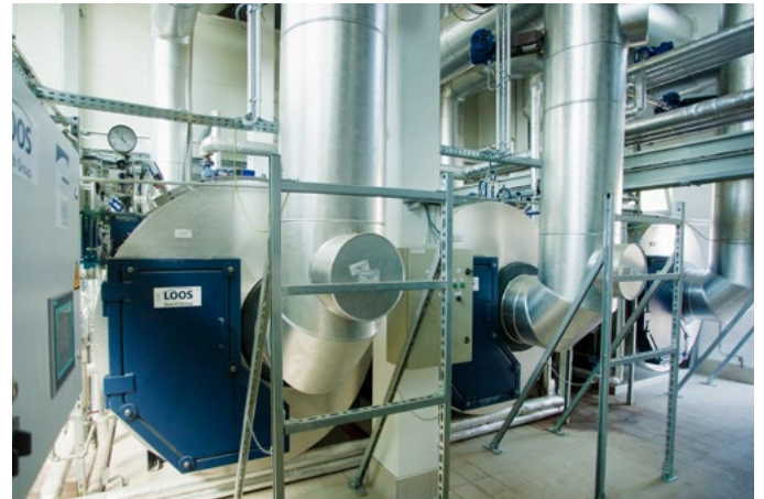
Die Abhitze-Kessel nutzen die Abwärme aus den Blockheizkraftwerken zur kosteneffizienten Dampferzeugung.
