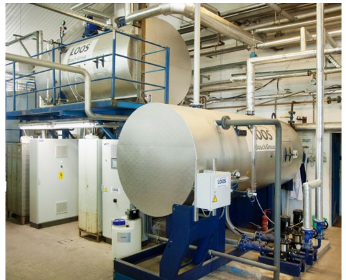
Entgasungsanlage (oben) für korrosionsfreies Speisewasser und Kondensatmodul zur Speicherung von rücklaufendem Kondensat.
