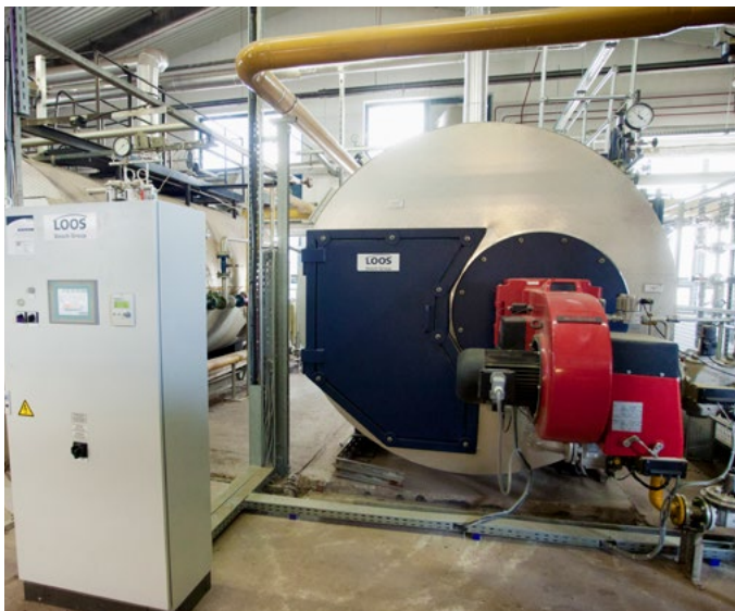
Der Dampfkessel UL-S gewährleistet bei Gallicoop die Versorgungssicherheit.
