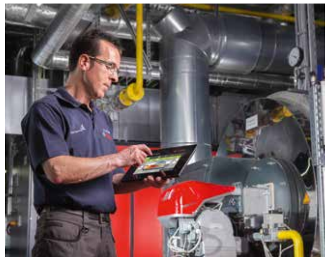
Die Inbetriebnahme des Gesamtsystems und die umfassende Einweisung des Bedienpersonals übernahm der Bosch-Kundendienst – für eine optimal eingestellte Anlage und effizienten Betrieb.
