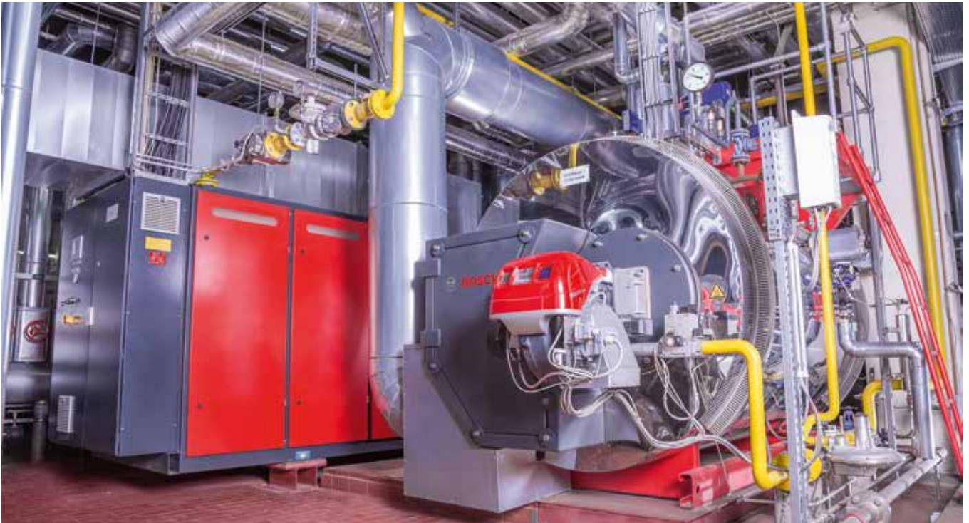
Effektiver Einsatz von Abwärmequellen: Die BHKW-Abwärme mit Temperaturen bis zu 550 °C werden in den vierten Zug des Dampfkessels geleitet und zur Dampferzeugung verwendet.
