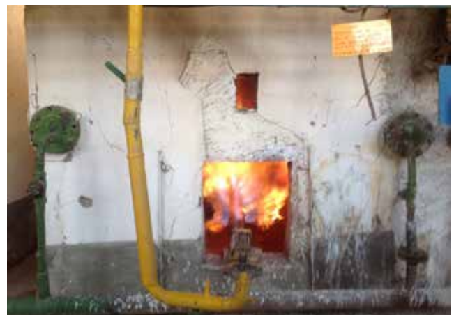
Ein Beispiel für die früheren Heizungsaggregate.
