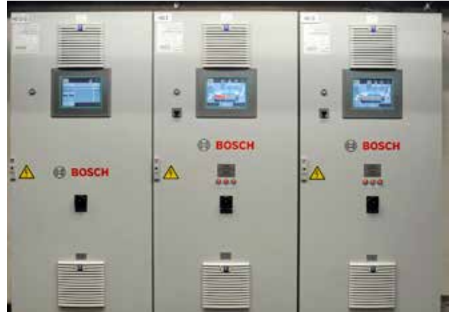
Die intelligente Steuerungstechnik ermöglicht einen optimalen Kesselbetrieb und bietet Versorgungssicherheit.
