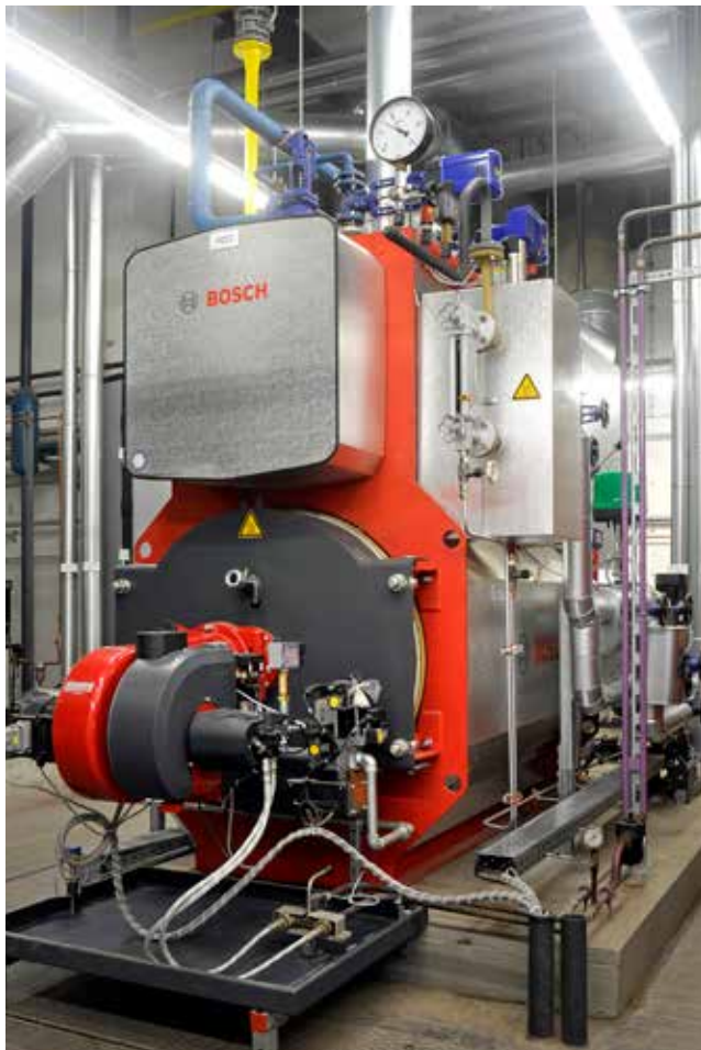
Der kompakte Dampfkessel U-MB mit Erdgasfeuerung und Economiser.
