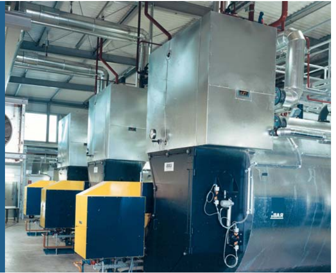
Figura 2: Ejemplo de aplicación en una fábrica papeleras, 3 calderas de vapor con recalentador
