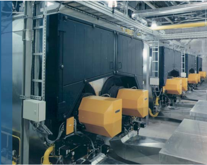
Figura 1: Fotografía de la instalación con 4 ZFR
