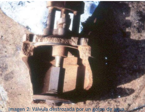
Imagen 2: Válvula destrozada por un golpe de agua.
