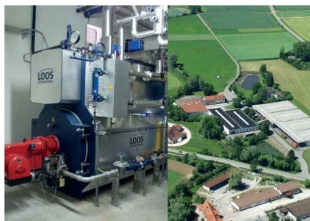
La caldera de vapor U-MB con control de arranque automático SUC en la empresa de bebidas Bissinger Auerquelle.
