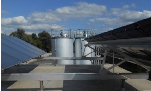
Photos: Aschoff Solar GmbH
