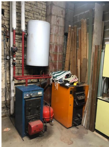
Ancienne installation extérieure et intérieure
