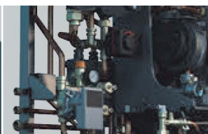
Pompes de circuits de chauffage
